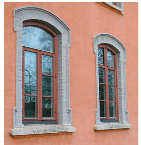
De båda bilderna illustrerar skillnaderna på de ursprungliga och de nuvarande fönstren i Gamla Skolan. På de nya fönstren har de lösa spröjsarna fallit bort på flera ställen. Foto ca 1900 och 2012.
